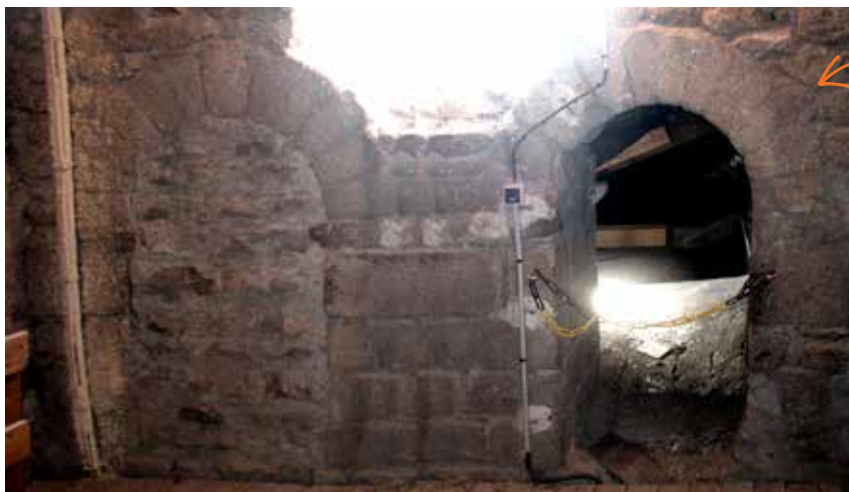
Les baies doubles du XII e siècle visibles à l'intérieur du clocher
